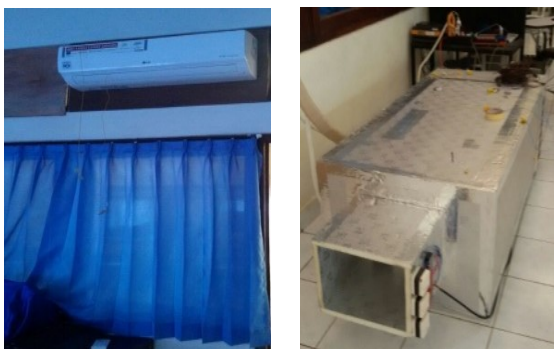
Gambar 3. Outdoor-indoor sistem AC split domestik untuk pengujian
