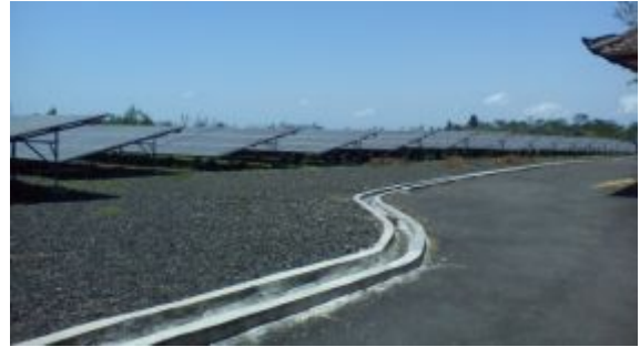
Gambar 4. Kondisi PLTS Bangli
