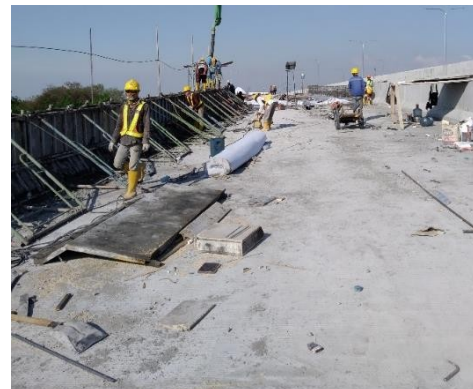
Gambar 4 Lingkungan Kerja Tidak Rapi
